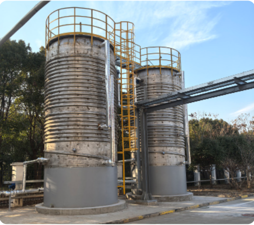
▲ 废水站废水排放改善
