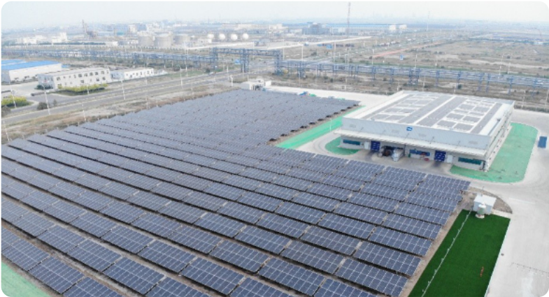
▲ 工厂安装分布式光伏项目
